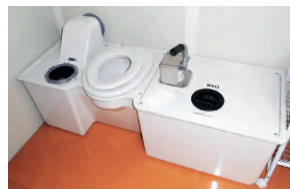
洋式トイレ (簡易水洗式)
